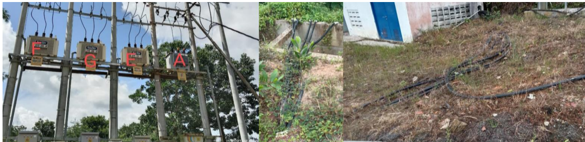
Gambar 3: Kondisi peletakan kabel power di kawasan ITK
