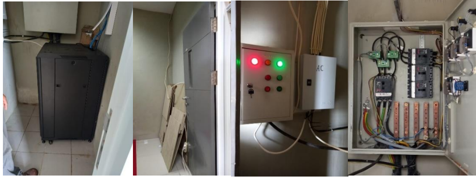
Gambar 2: Kondisi ruang panel, tarikan distribusi tenaga listrik tegangan rendah dan isi panel
