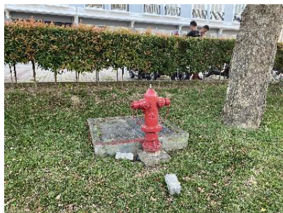
Gambar 8. Jalur hydrant pada kawasan Perumahan Grand City
