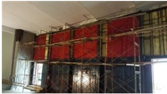
Gambar 22: Sistem peredam yang dipasang pada Auditorium RRI Surakarta Sumber : CV. Adiluhung Consultant
