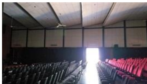
Gambar 16: Sistem Penghawaan Auditorium RRI Surakarta Sumber : Dokumentasi Pribadi
