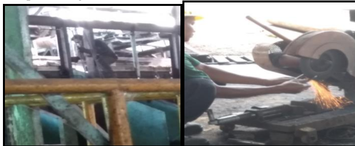
Gambar 1: Pekerja Tidak Menggunakan Alat Pelindung Diri (APD) (Sumber: PT. XYZ, 2018)
