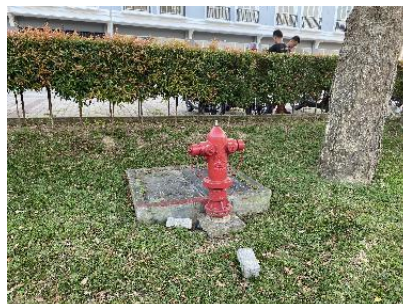
Gambar 8. Jalur hydrant pada kawasan Perumahan Grand City
