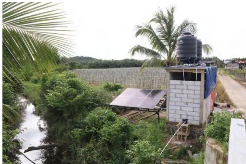
Gambar 2. Sistem PLTS dan Filter Air
